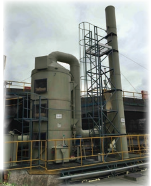
廢水處理水洗塔
