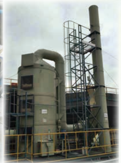
廢水處理水洗塔
